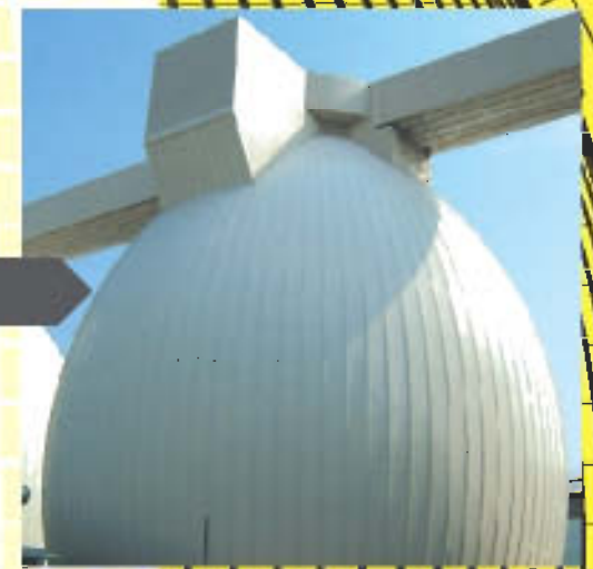
⑤ 神戸東灘消化タンク2号機
